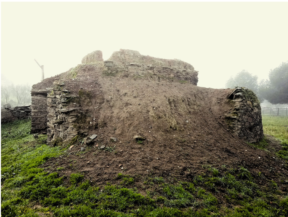
Imagen 8: al haber retirado el muro, este lado del tejat ha quedado destrozado y expuesto a un deterioro acelerado. Especialmente la erosión de la lluvia arrastra la tierra, lo que afecta también a la cámara y la caldera
