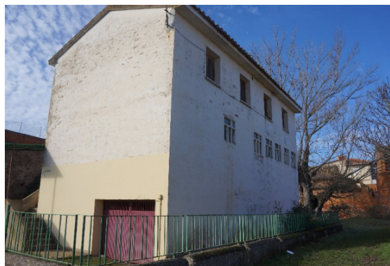
Fachadas principal y posterior de la escuela de La Nora del Río. Estado actual
